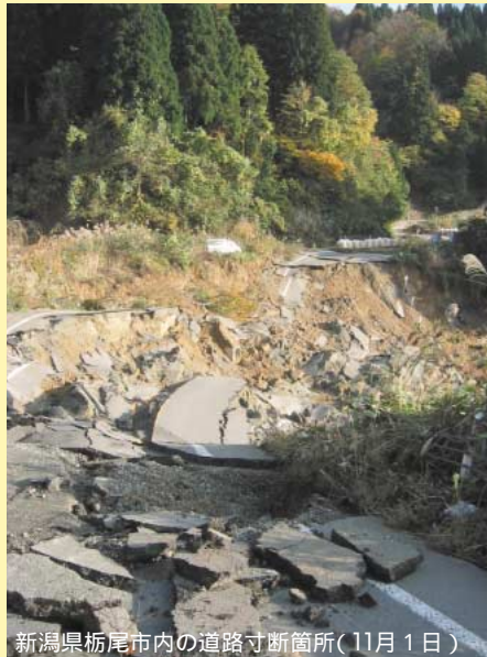
新潟県栃尾市内の道路寸断箇所(11月1日)
